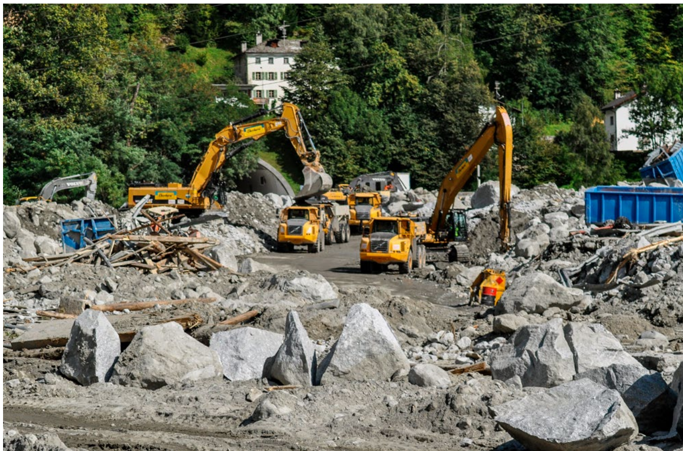
Spezialbagger arbeiten im vollen Auffangbecken bei Bondo. Im Falle eines Alarms müssen sie innerhalb von vier Minuten die Gefahrenzone zu verlassen.
