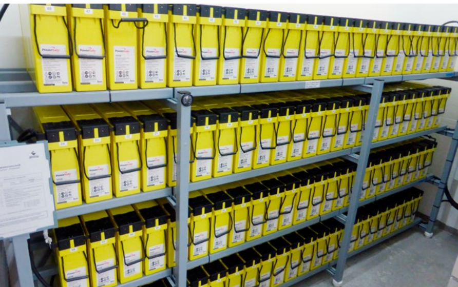
Batterien sorgen für eine unterbrechungsfreie Stromversorgung (USV).
