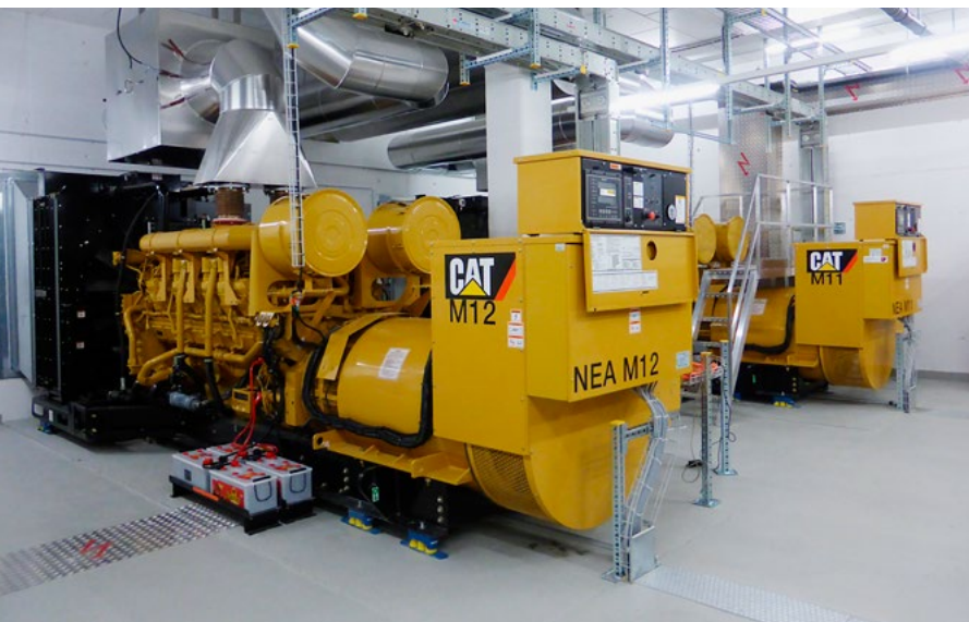
Heutzutage verfügen viele Gebäude über Notstromanlagen. Fällt bei einem grossflächigen Stromausfall aber auch die Telekommunikation aus, nützt dies unter Umständen nichts.
